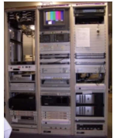
マシンルーム内 機器
